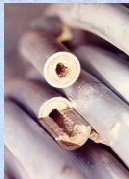
Incrustações em tubos de água, pela presença de cálcio.
